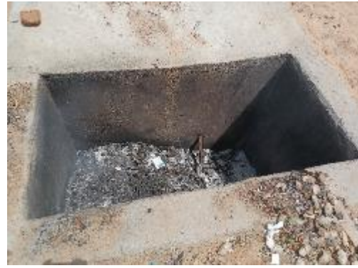
Photo 39: puisard de stockage des cendres des déchets incinérés
